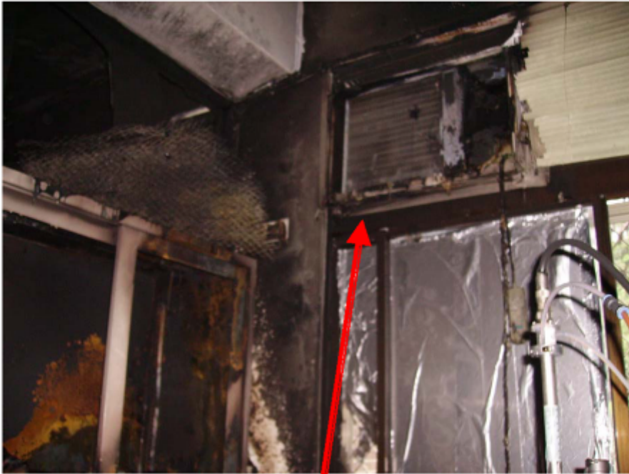
冷氣機及冷氣機下方開關燒燬情形
