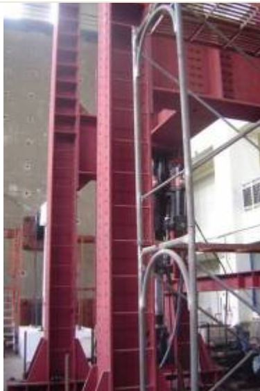
鋼構內置爬梯宜加設安全母鎖
