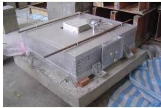
高溫設備宜加警告標示
