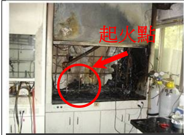
圖 1、災害現場燒毀之抽氣櫃(一)
