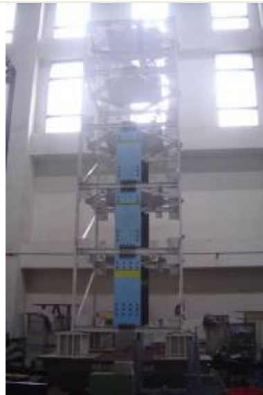
大型實驗構架無適當之爬梯
