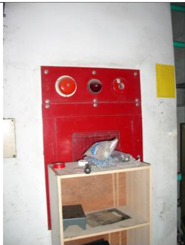
圖 10、置物櫃阻擋走廊消防栓之操作
