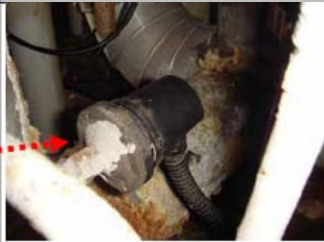
熱感知器未拆解前
