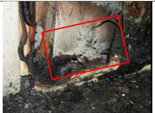
圖 4、於抽氣櫃內加裝之插座燒毀情形
