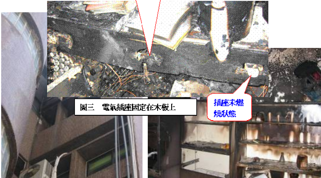
插座上電線被燒毀狀態
