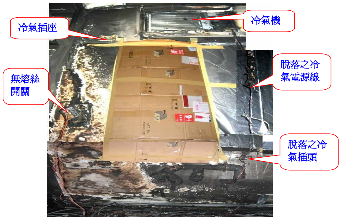
圖一 內牆電氣線路配置情形
