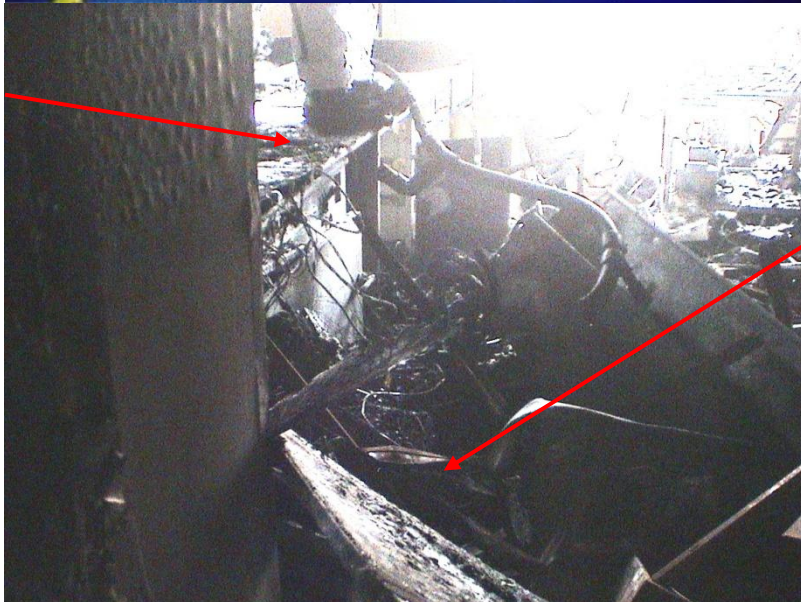
四公升正己烷溢流處
