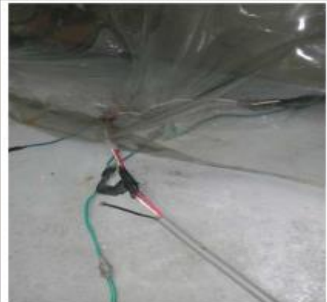
電源線與接地線接點以絕緣塑膠貼布接合，放置於地板，於清洗底板時易產生感電之危害。
