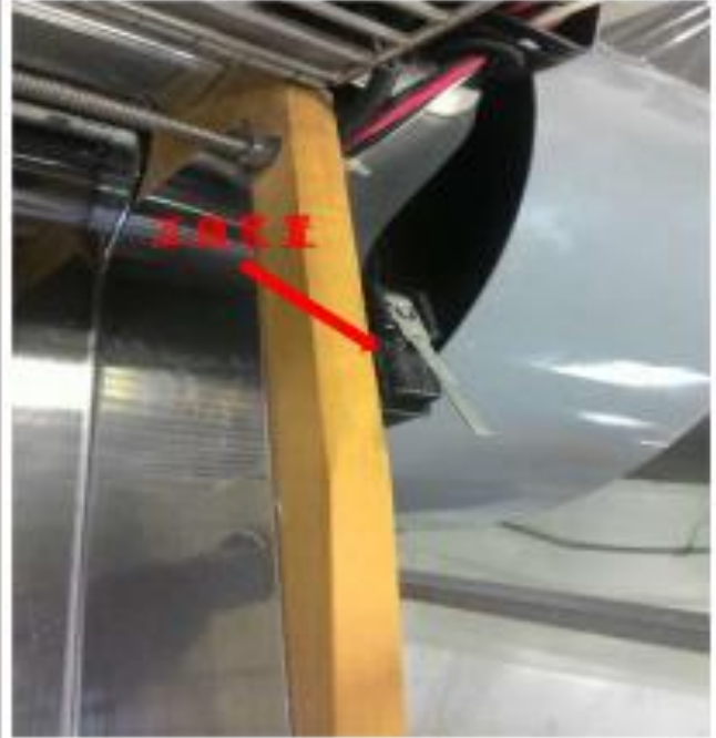
護罩下方設有互鎖裝置，功能正常
