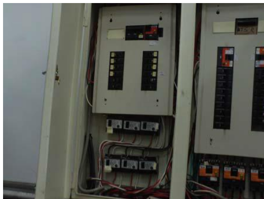
說明：總電源箱未加裝保護蓋板
