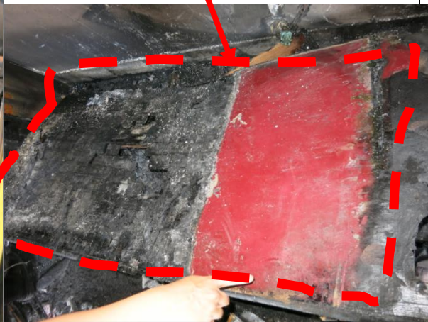
(疑似起火點)OO 實驗室外走廊木櫃桌面燒毀情形
