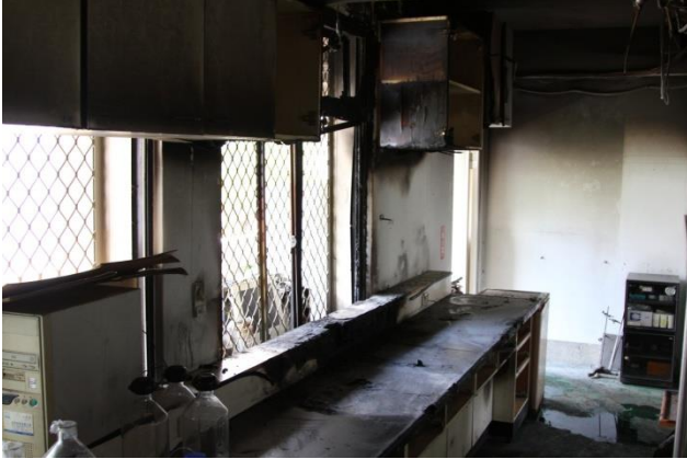
1. 燒毀的區域(實驗桌和吊櫃)
