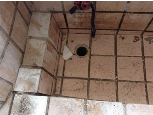
未經評估作業方法與危害，以固體苛性鈉倒入進水口，試圖疏通水管。
