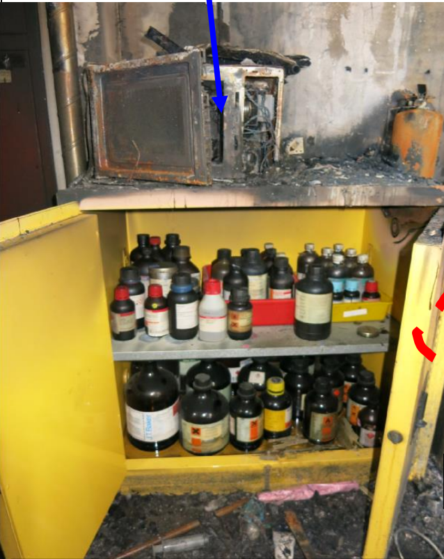
疑似起火點左側防爆櫃(內置化學品，上置微波爐)
