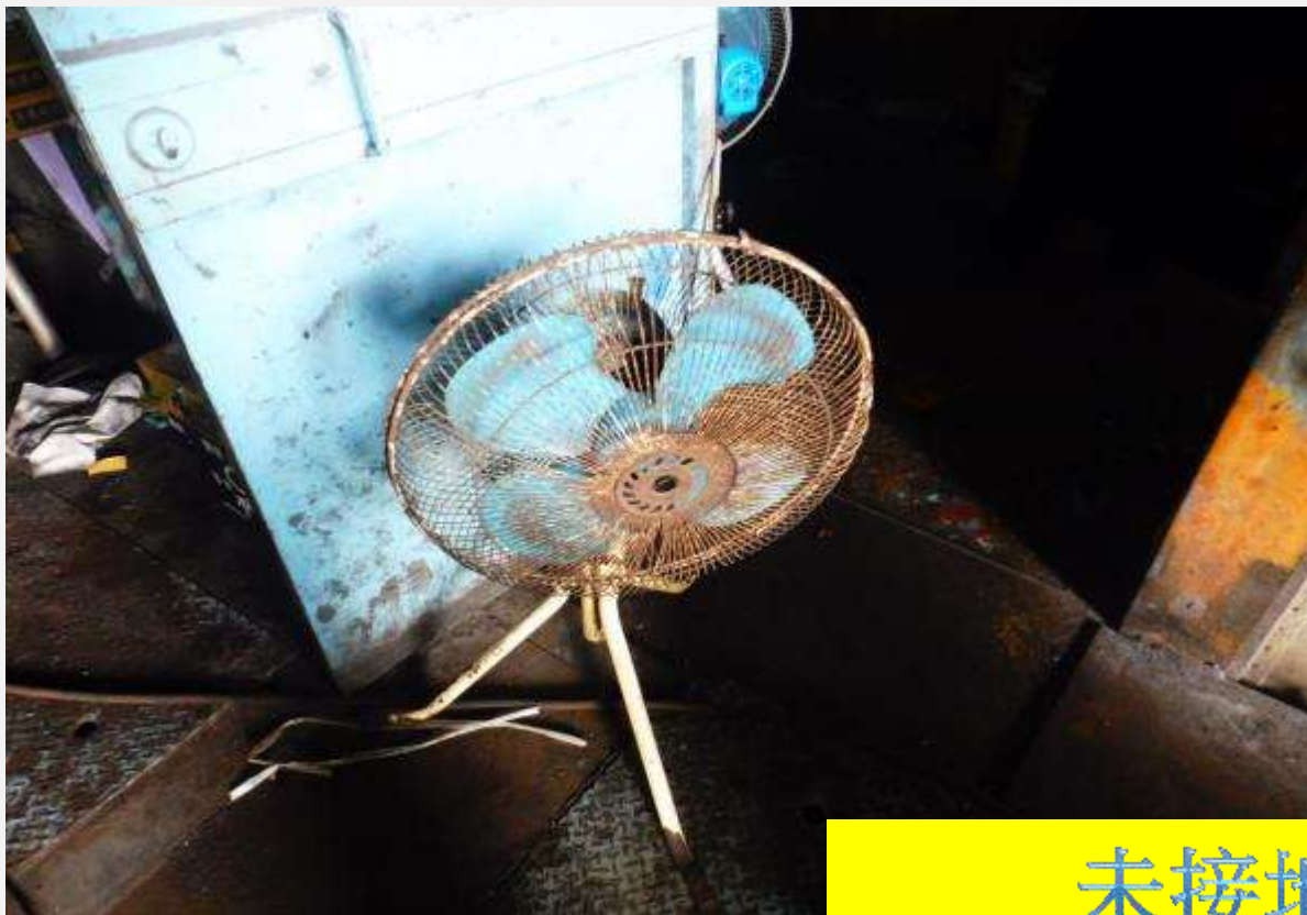
工業電扇漏電死亡
