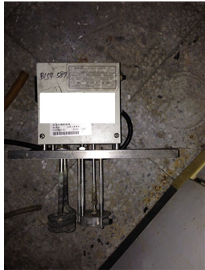
疑似發生異常引起災害之未具有安全裝置的恆溫加熱器相同款設備
