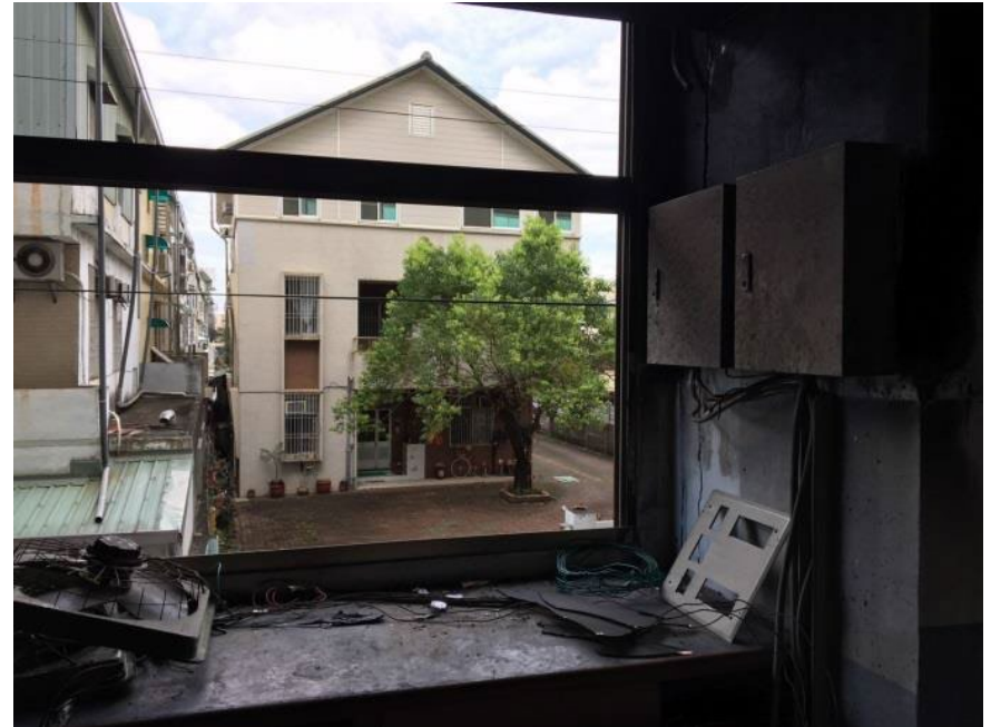
桌面保留燃燒後痕跡，窗戶玻璃已損毀
