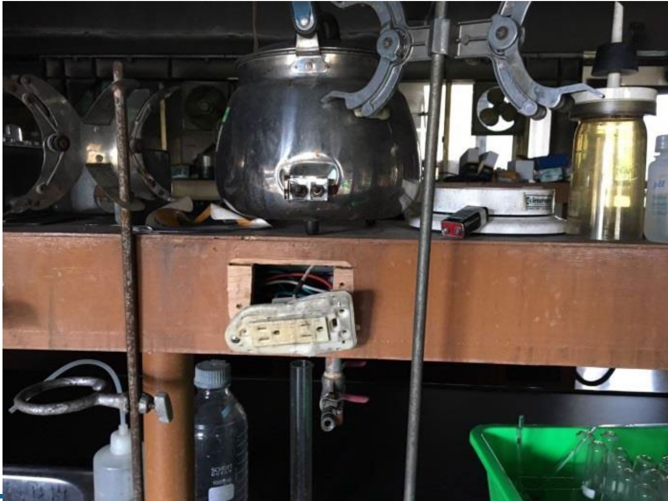
東邊第二實驗桌，部分桌面與插座外殼也受損
