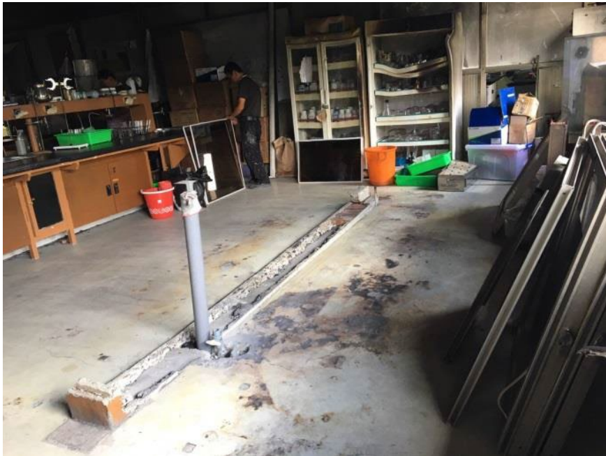
第三實驗桌全毀並已完全拆除
