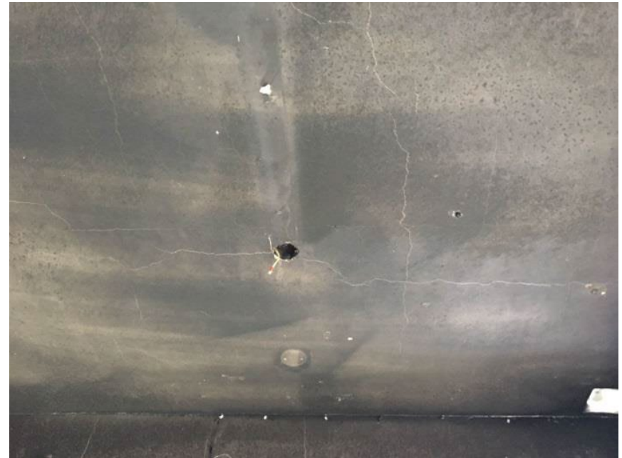
上方天花板處呈現燻黑狀態燈具已毀損
