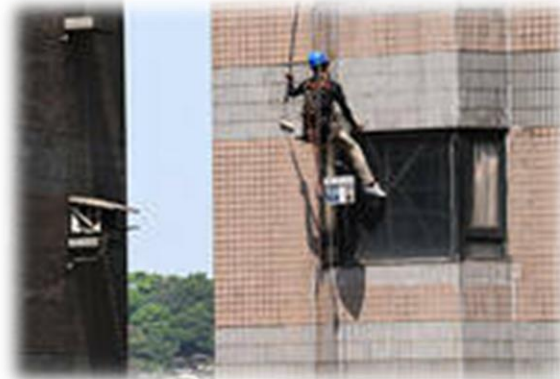
▲圖1：一名施工人員僅綁繩索就吊掛在建築物11樓外牆作業，令人膽戰心驚。
