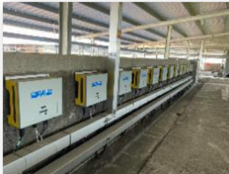
▲如圖5、6太陽光電發電維運場所之電力組配設備，應設置圍柵、屏障
