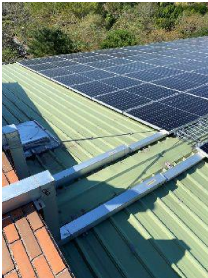
▲圖3、4屋頂之案場應設置護欄、安全母索及安全上下設備，並規劃安全通道
