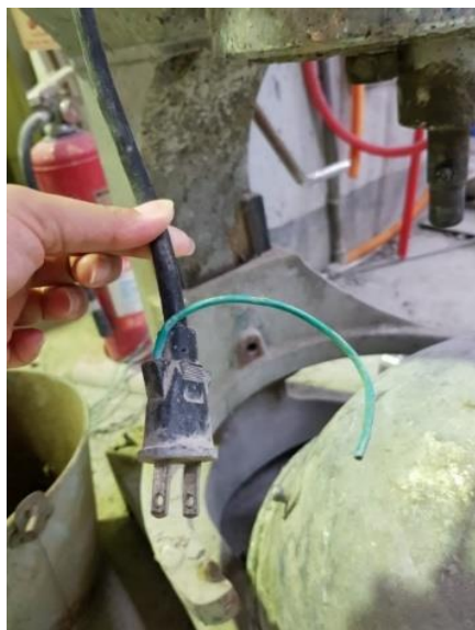
圖1-2：用電設備未確實接地。
