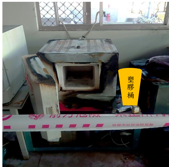
高溫爐災後現場照片
