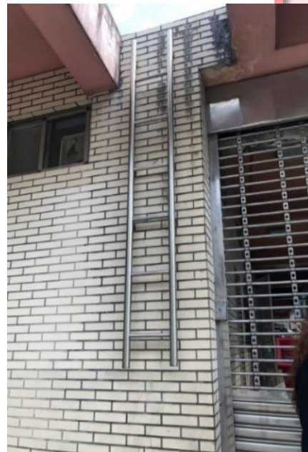
圖2-4： 未設置安全上下設備。
