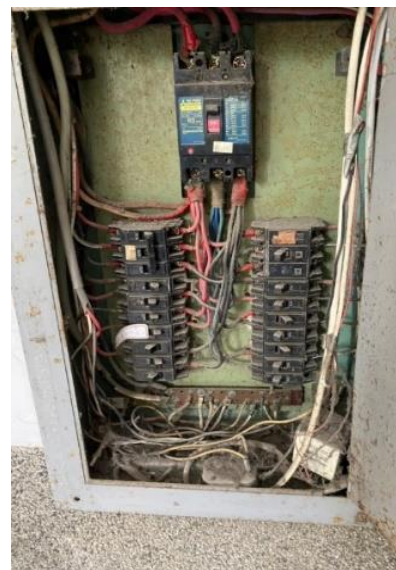
圖1-3：配電盤之一次或二次側等金屬裸露位置未設有絕緣披覆。
