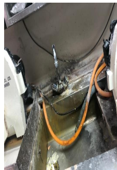
圖1-4：潮濕場所或導電性良好場所之用電設備未裝設漏電斷路器。
