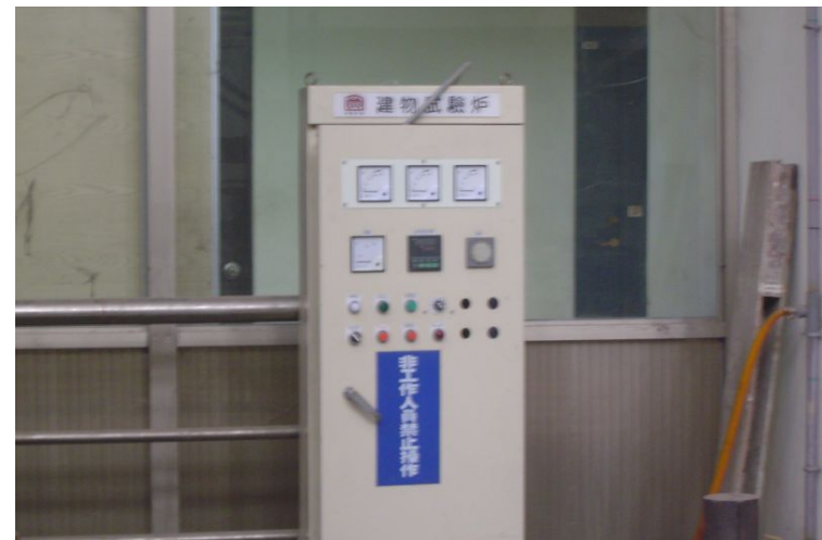
53 配電盤未上鎖管制 撰寫人:逢甲大學總務處張麗雲組員
