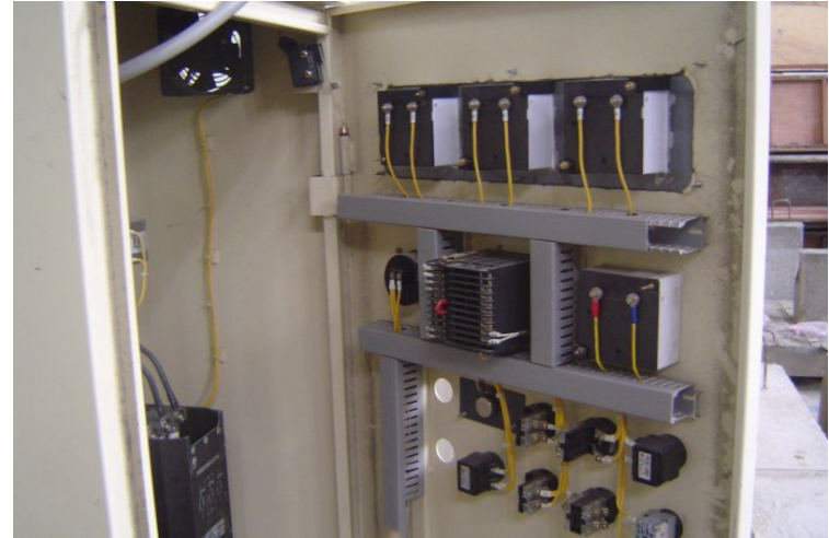
電線接頭並無防止感電裝置
