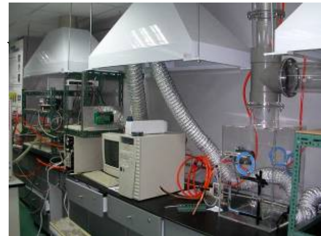
局部排氣裝置
