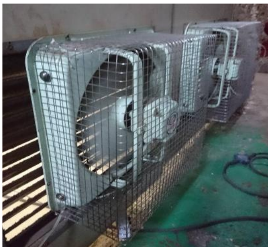
▲壁扇、工業用電扇未設護網或護圍
