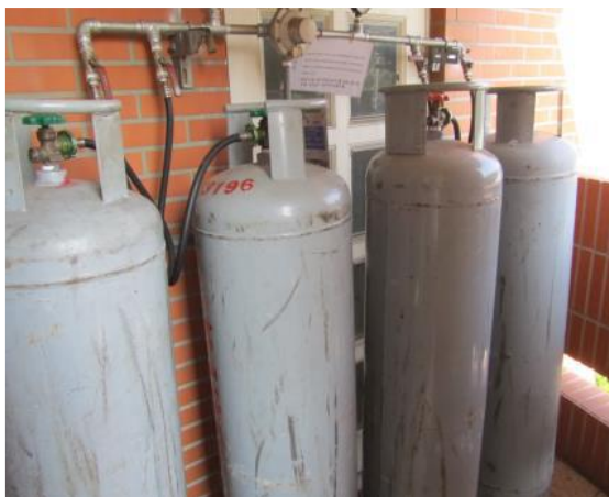
▲瓦斯鋼瓶未固定及管路未定期檢查
