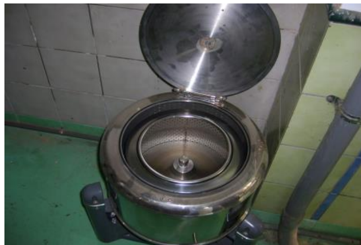
▲脫水機離心機械應依規定設置連鎖裝置
