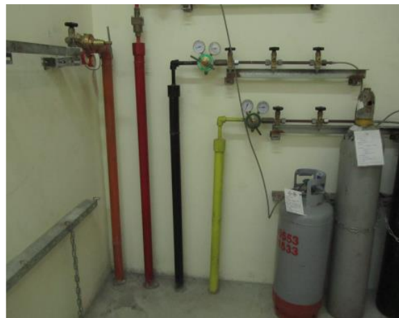
▲儲氣室氣體管路未標示氣體種類及流向未設置氣體洩漏偵測器
