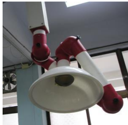
▲局部排氣管路脫離及未每年依規定定期實施檢查一次
