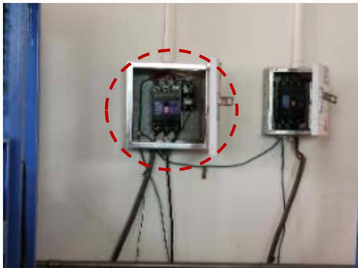
潮濕場所未置合格漏電斷路器
